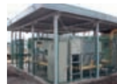
天然ガス供給設備
